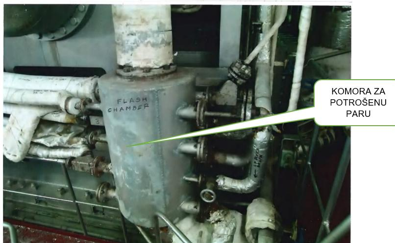
Slika 4. Cjevovod potrošene pare prema komori
