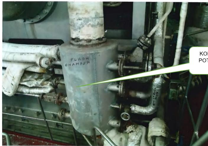
Slika 4. Cjevovod potrošene pare prema komori
