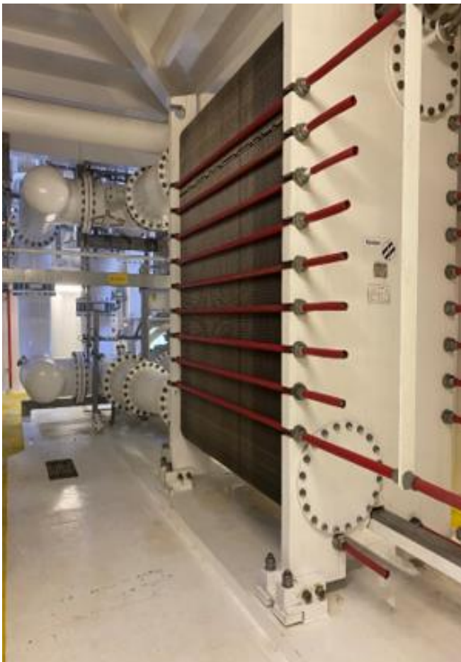
Slika 14: Izmjenjivač topline morska voda / glikol
