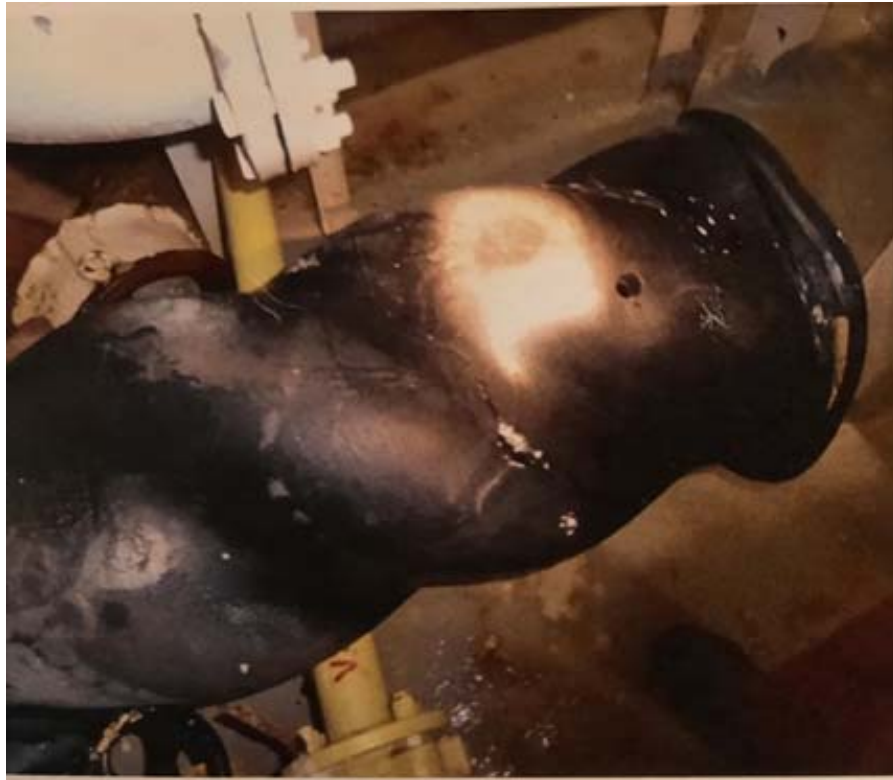
SLIKA 2. Statorska guma otkinuta s kućišta
