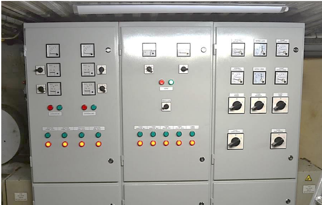
SLIKA 5. Glavna razvodna ploča
