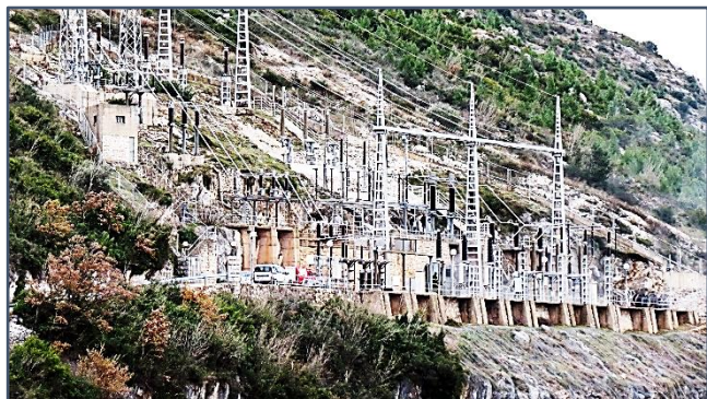
Rasklopno postrojenje kao dio sustava HE Dubrovnik
